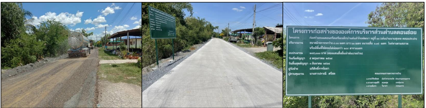
โครงการก่อสร้างหอดึงเหล็ก บ้านดอนมะกอก หมู่ที่ ๕
